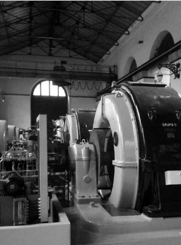
Fig. 6. - Central hidroeléctrica de Somiedo: sala de máquinas con tres turbinas. Fotografía de Elena Vigliocco, 2016.
