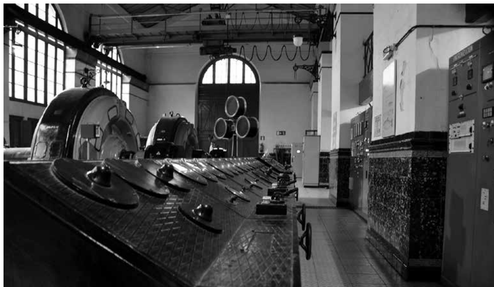
Fig. 8. - En primer plano el panel de control original, de 1917 y actualmente abandonado, de la central hidroeléctrica de La Malva en Somiedo; detrás el panel de control actualmente en funcionamiento. Fotografía de Giorgia Palma, 2016.
