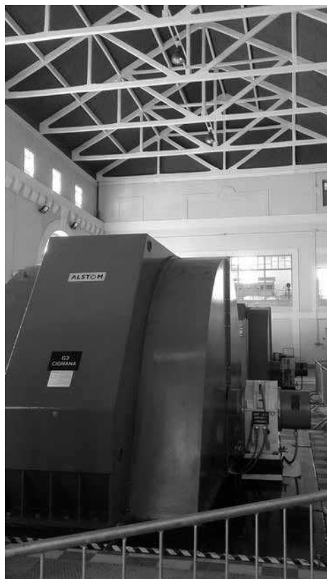
Fig. 5. - Sala de los transformadores de la central hidroeléctrica de Maen (Aosta). Fotografía de Elena Vigliocco, 2016.
