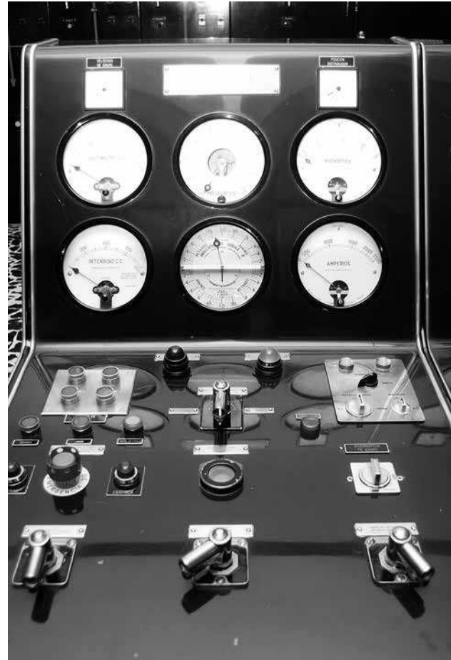
Fig. 4. - Cuadro de Mandos en central Hidroeléctrica en Salime. Fotografía de Miguel Ángel Álvarez Areces, 2011.
