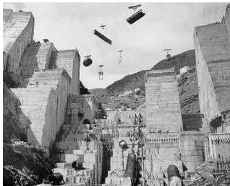
Fig. 2. - Vista de la Presa aguas abajo en la fase de colocación de las tuberías de toma, 1952. Fuente: Saltos del Navia.
