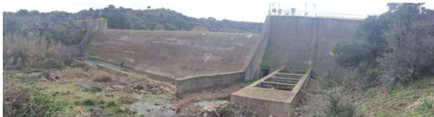
Foto 1 Situazione diga Fiumara pre-esistente, montanti su coronamento in parte piegati, fune provvisoria pericolosa
