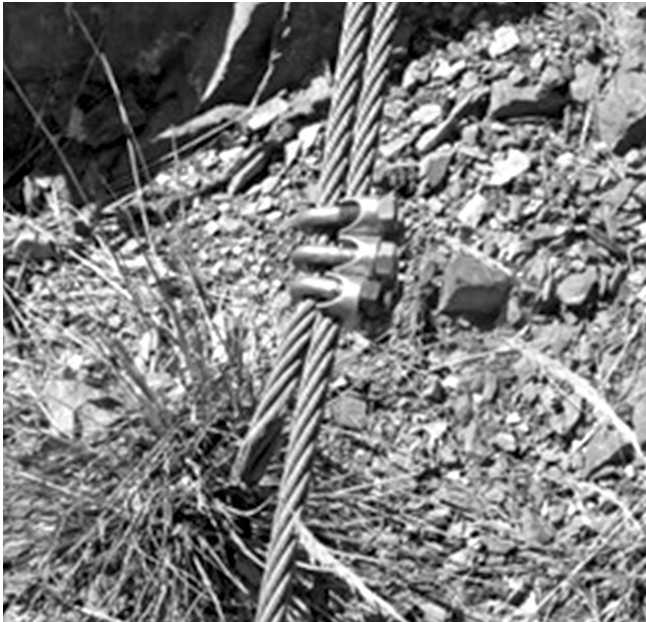
Fig. 11. Esempio di morsetti scorsi a seguito di un impatto. Example of clamps, that moved after an impact.
