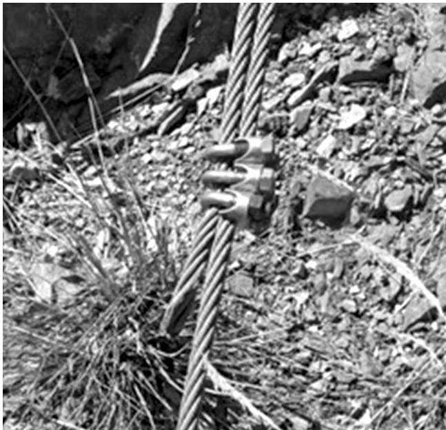
Fig. 11. Esempio di morsetti scorsi a seguito di un impatto. Example of clamps, that moved after an impact.
