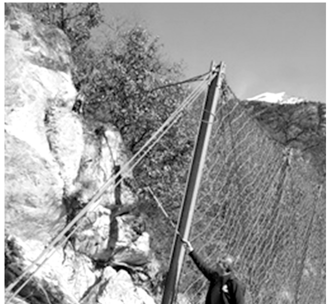
Fig. 6. Esempio di un controvento di monte sub orizzontale e di ridotta lunghezza. Example of sub horizontal and short upstream cable.
