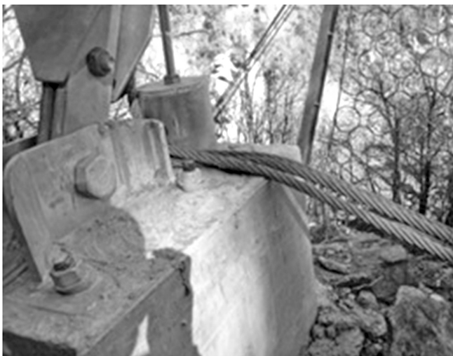
Fig. 5. Esempio di plinto del montante che interferisce con la fune longitudinale impedendone il corretto scorrimento. Example of foundation plinth of the post that interferes with the longitudinal steel cable, preventing the correct sliding.
