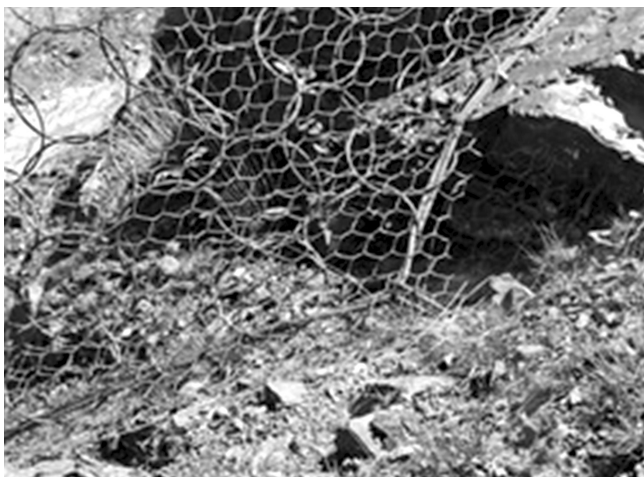
Fig. 9. Esempio del varco al piede chiuso con ancoraggio della fune longitudinale tra i due montanti.
