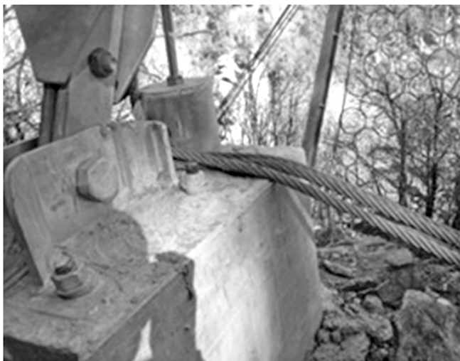
Fig. 5. Esempio di plinto del montante che interferisce con la fune longitudinale impedendone il corretto scorrimento. Example of foundation plinth of the post that interferes with the longitudinal steel cable, preventing the correct sliding.
