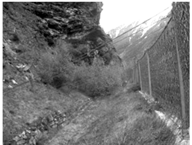
Fig. 7. Esempio di controventi di monte più lunghi di quanto prescritto nel manuale di montaggio. Example of upstream cables longer of what recommended in the installation manual.
