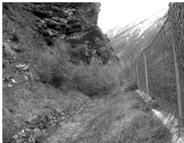
Fig. 7. Esempio di controventi di monte più lunghi di quanto prescritto nel manuale di montaggio. Example of upstream cables longer of what recommended in the installation manual.
