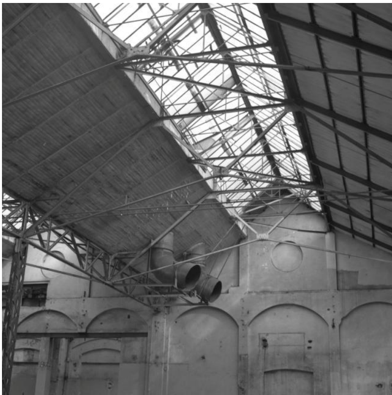
FOTO 16(BB). Lo scatto mostra dall'interno il tamponamento in muratura delle due campate principali del grande capannone che si affacciava lungo corso Rosselli.
