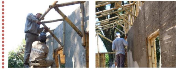
• Documentación extraída de la presentación del profesor H. Saleme en el seminario Construir con el Delta, coordinado por Clara Peña y por quien suscribe en la Sociedad Central de Arquitectos, Abril 2014.
