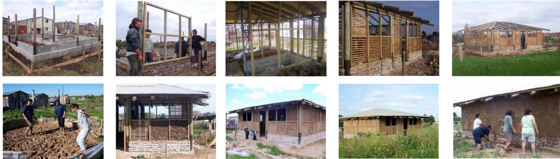
Las fotografías reflejan el trabajo comunitario y permiten apreciar todas las etapas de la obra, desde la elaboración de fundaciones en HºAº, hasta el acabado final de las paredes de barro. fuente: ETCHEBARNE,PIÑEIRO, SILVA, 2006 y en fuente web: http://www.inteligenciascolectivas.org/cooperativa-vaimaca-en-uruguay/
