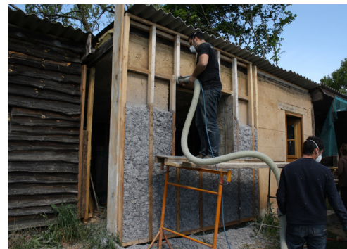
Fig. 6.50, Isolamento esterno con ovatta di cellulosa pompata con compressore su parete in terra battuta e struttura di supporto in legno. (Foto Caracol)
