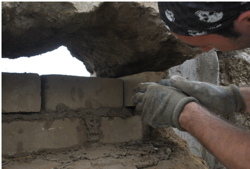
Fig. 5.29, I blocchi di terra compressi vengono agevolmente divisi e posati a completamento dei filari anche negli spazi angusti dovuti all'irregolarità delle dimensioni dei fori nella parete.
