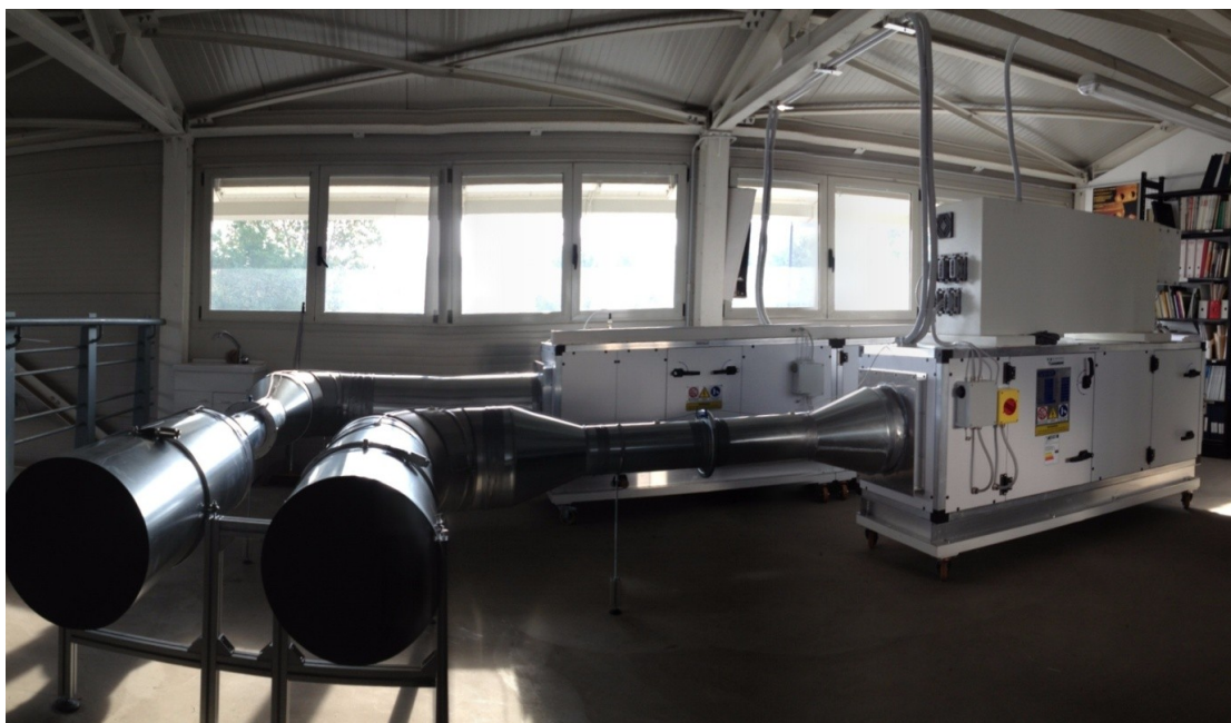
Immagine del circuito prova con le 2 UTA
