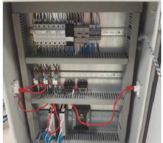
Fig. 2. Control module cabinet.
