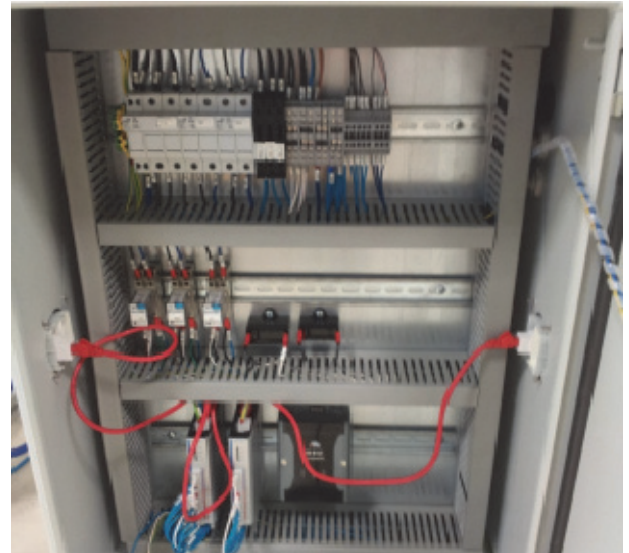
Fig. 2. Control module cabinet.
