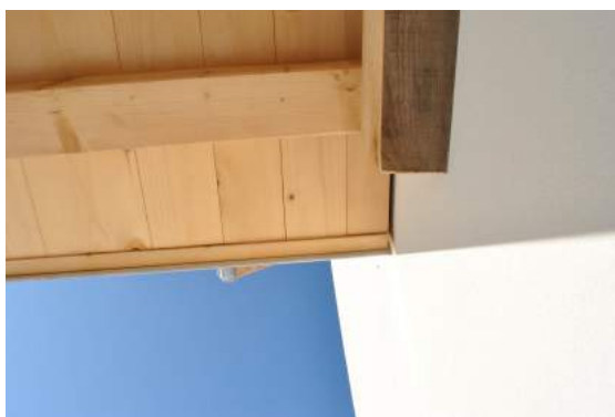
Figura D.10: Particolare dell'attacco dell'assito del pavimento del balcone autoportante: risulta staccato rispetto alla chiusura verticale per non intaccarla (A.R. Bertorello, 04.05.13)
