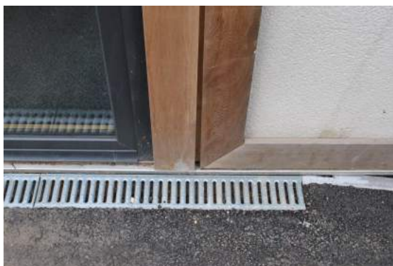
Figura B.13: Particolare attacco a terra: drenaggio acque meteoriche. Presenza di colatura di acqua direttamente sulla finitura esterna ad intonaco.
