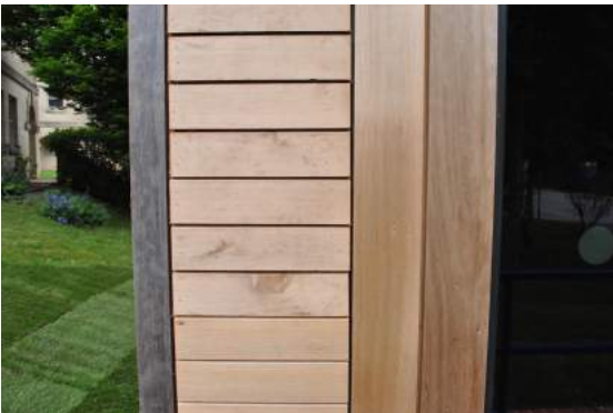
Figura B.12: Particolare della nuova pannellatura esterna: differenza di colore tra listello verticale ossidato e i nuovi listelli.
