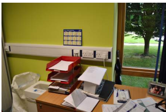
Figura B.8: Posizione delle prese elettriche a parete e impianto elettrico a vista.
