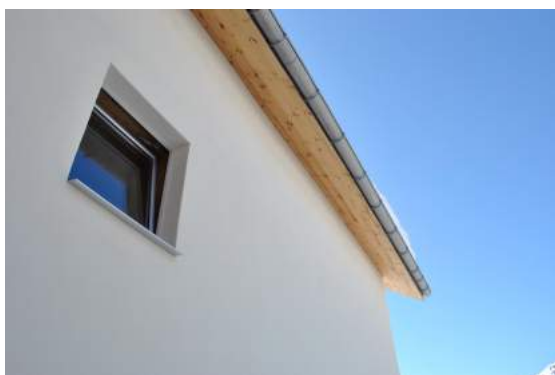
Figura D.5: Sporto della copertura, di nuova realizzazione, e chiusura verticale isolata in paglia (A.R. Bertorello, 16.03.13)
