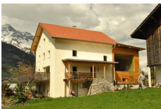
Figura D.3: Scala esterna in pietra, smontata e ricostruita per realizzare l'intervento di isolamento (A.R. Bertorello, 04.05.13)
