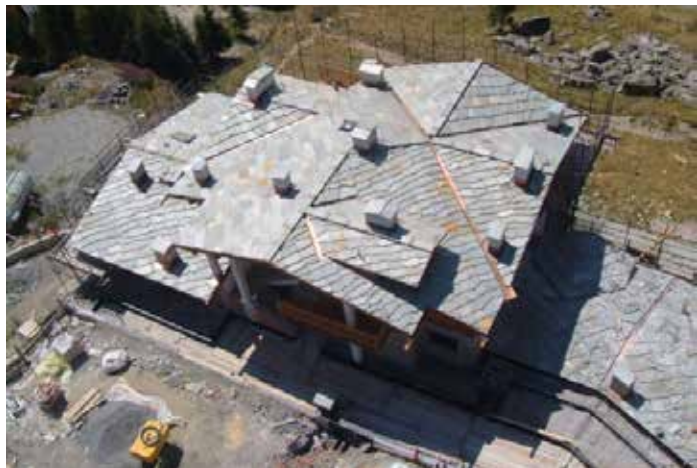
Tetto in lose in alta Valle d'Aosta
