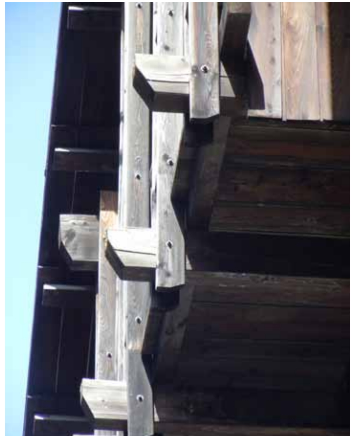
Sauze di Cesana. Intelaiature, balconate e rivestimenti parietali (anni ottanta): alterazioni cromatiche, abrasioni.
