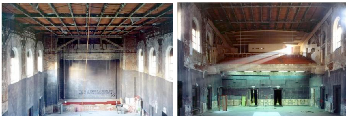
Figura 4. Alcune immagini degli interni dopo il lungo periodo di abbandono: lo spazio della sala è stato profondamente compromesso con la demolizione della galleria. Foto: Biamino, 2004.
