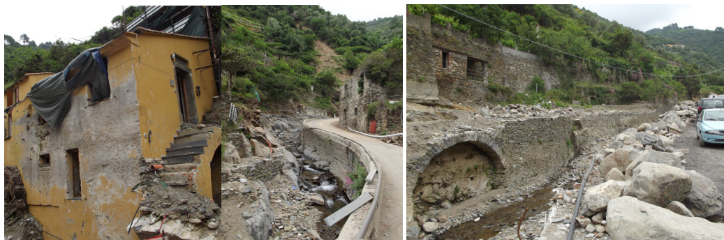
Figura 2. Esempi di danni a manufatti edilizi lungo il corso del Vernazzola (foto P. Maschio).
