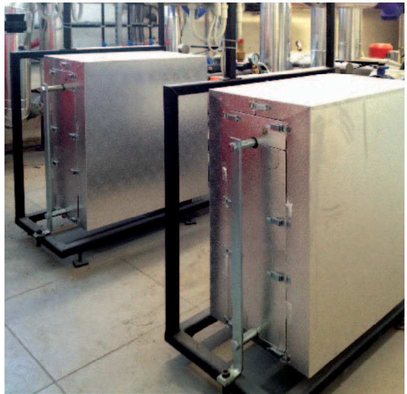
Figura 6. Un dettaglio degli scambiatori di calore. I circuiti delle utenze sono stati tutti dotati di contabilizzatori di energia termica
