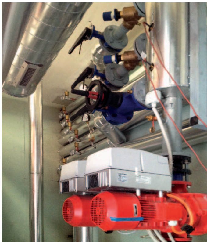
Figura 3. Un dettaglio delle pompe installate sul circuito di teleriscaldamento, equipaggiato con dispositivi in versione gemellare
