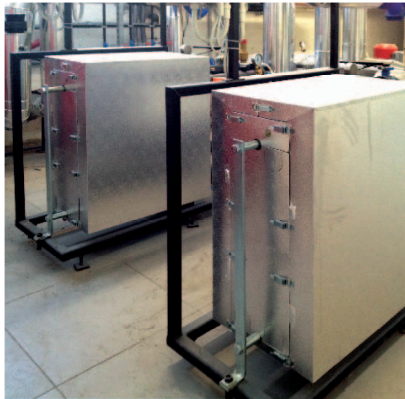
Figura 6. Un dettaglio degli scambiatori di calore. I circuiti delle utenze sono stati tutti dotati di contabilizzatori di energia termica
