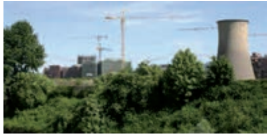
La cosiddetta "spina 3" in trasformazione (2005). Dello stabilimento Michelin resta solo la torre di raffreddamento, troppo costosa da abbattere.
