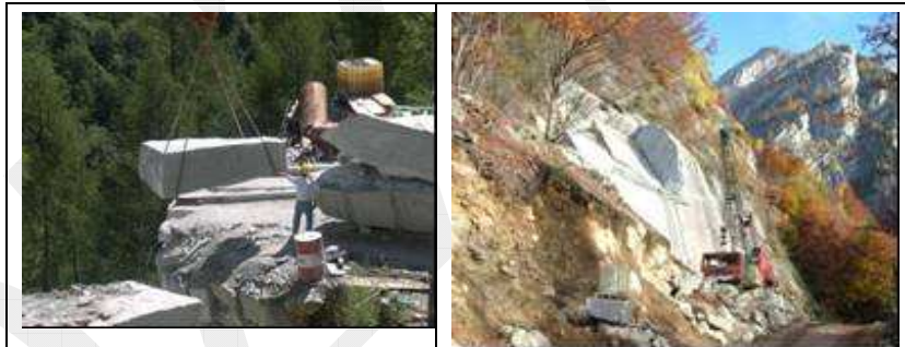
Fig.2: Movimentazione meccanica con mezzi di sollevamento fissi
