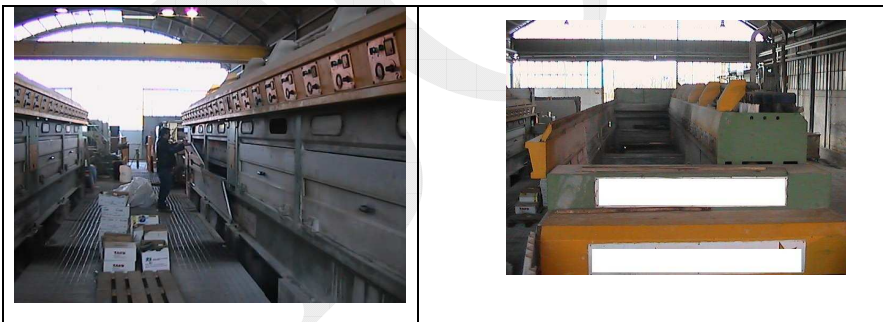
Fig.3: Linee di trattamento superficiale a nastro
