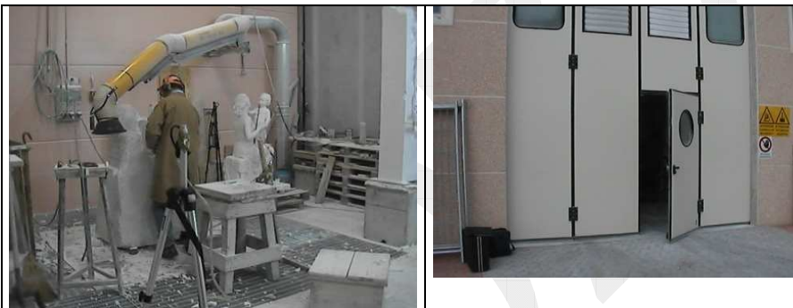
Fig.5-6: Cappe aspiranti orientabili (3) e griglia a pavimento (4)
