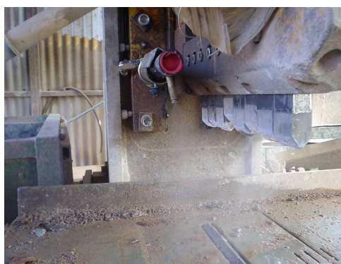
Fig.4: Abbattimento con getti di aerosol su spaccatrici / cubettatrici
