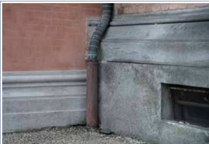
Castello di Racconigi, fronte sud, particolare dell'ammorsamento tra l'ala ottocentesca, con il basamento in pietra grigia di Malanaggio, e il corpo centrale del XVIII secolo.
