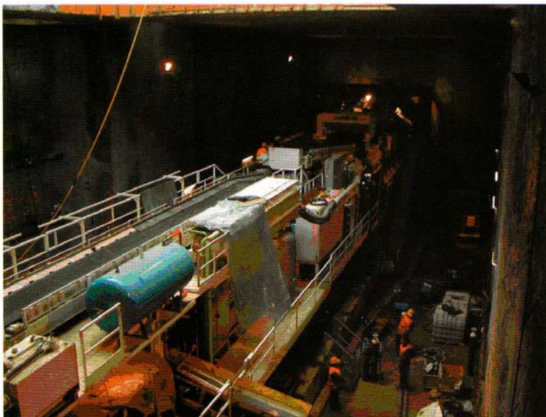
Foto n.5. El transportador sin la protección;
