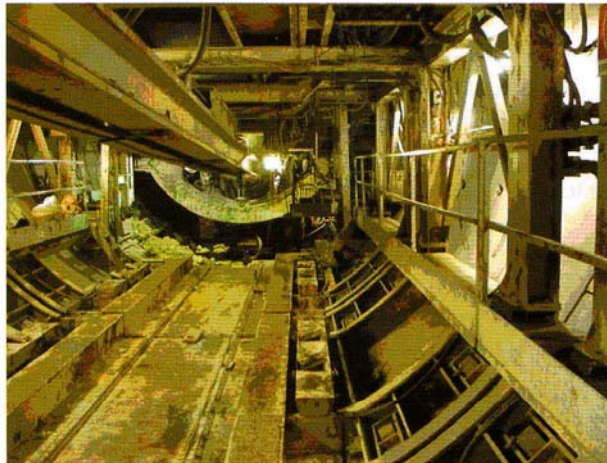
La figura n.3 muestra la descarga del segmento y su transporte al área del montador. Las trayectorias laterales estrechas conducen al frente, evitando el espacio ocupado por los segmentos.
