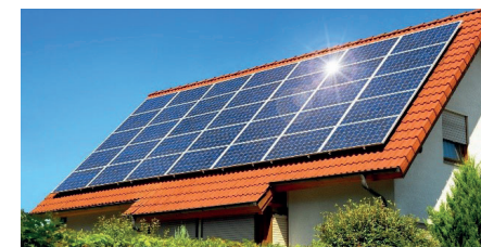
Impianto fotovoltaico da https://efficasa.it/blog/fotovoltaico-e-storage/impianto-fotovoltaico-ai-sola-come-funziona-e-perche-conviene
