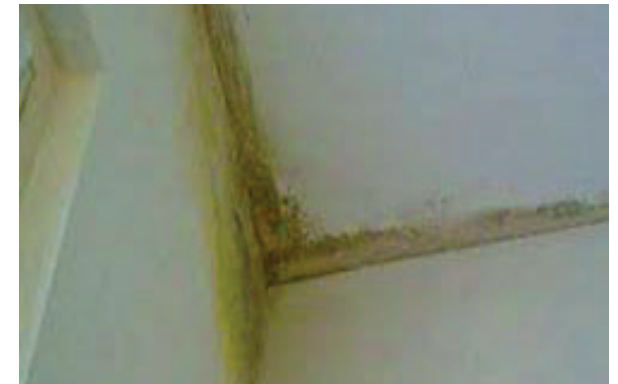
Muffe e batteri visibili a causa di un ponte termico da https://www.bioisotherm.it
