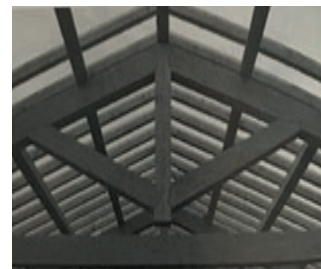
Capriate in legno con terzene e correntini da Campioli A., Lavagna M., (2013), Tecniche e architettura , Città Studi Edizioni
