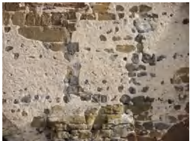
fig. 4 – Chanteuges (Haute-Loire), bâtiments abbaciaux (fin XII e -début XIII e ), crépis « sacrificiels » médiévaux laissant apparaître les remplois et la diversité des appareils et matériaux (Cl. B. Phalip).
