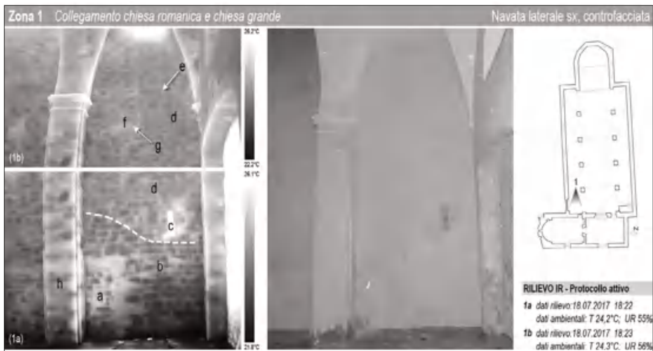
fig. 4 – Bagnasco (CN), chiesa grande di Santa Giulitta, termografia infrarosso della controfacciata (parte orientale).
