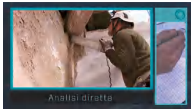
fig. 3 – Fotogramma riguardante le prove di resistenza sulle strutture lignee della torre nord-ovest.
