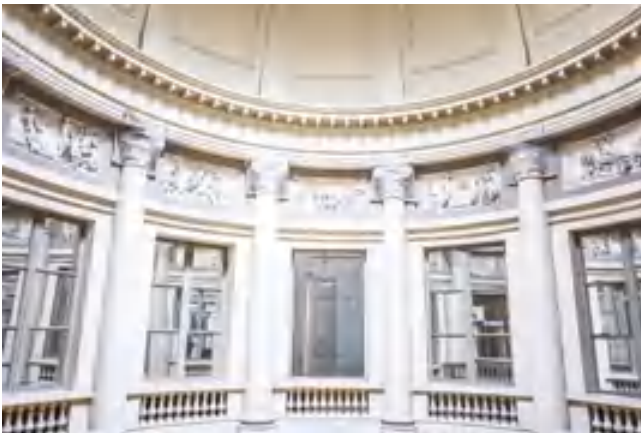
fig. 14 – Dettaglio dell'apparato decorativo in stucco con capitelli ionici fortemente compromessi e bassorilievi parte del ciclo opera dello scultore J.-P. Boiston, che in origine presentava probabilmente una finitura pittorica a simulazione del bronzo (©Nicola Vigilanti, 2020).
