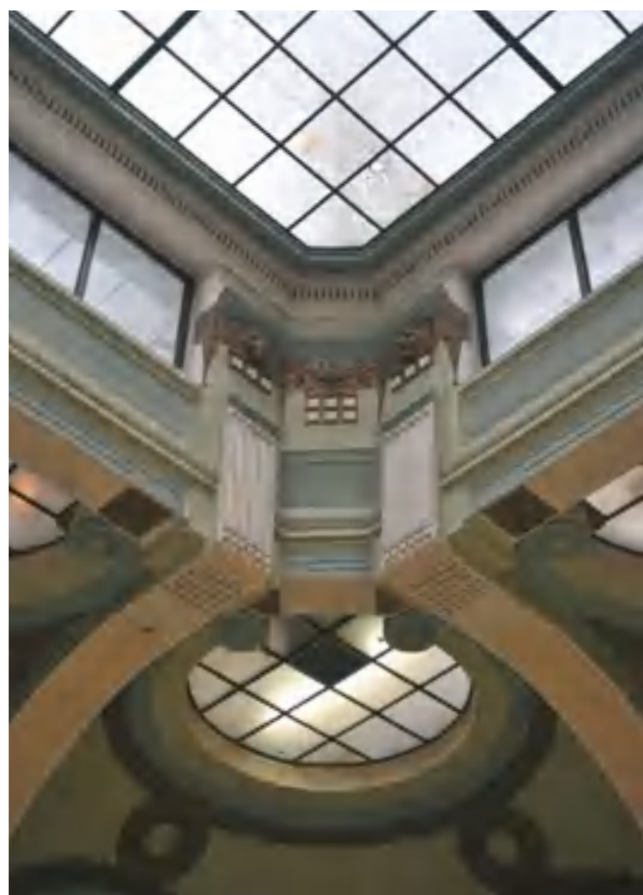
fig. 3 – Palazzo Poste e Telegrafi in via Alfieri a Torino, salone centrale, particolare delle scelte per l'apparato decorativo e dettaglio della copertura (PoliTo DIST-LSBC, fotografia di D. Capodiferro, 2010).
