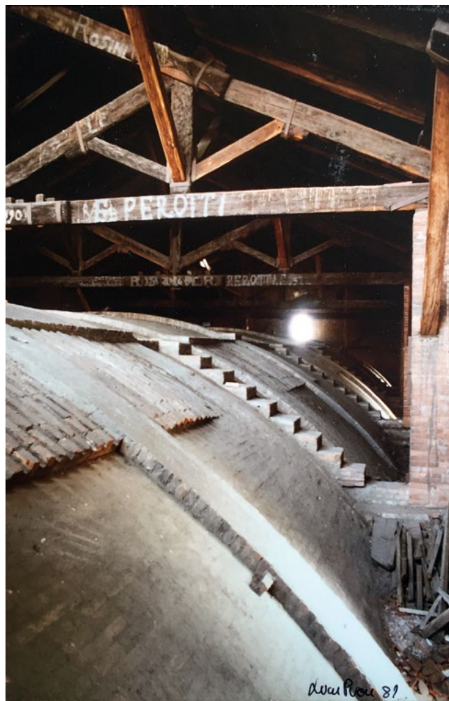
Figura 5. È esplicita la necessità del documentare parti non facilmente accessibili, in particolare l'estradosso delle volte e la copertura, per comprendere l'impostazione della struttura a conferma del rilievo-progetto. Novara, Cattedrale. Foto di Luca Pron, 1989. © Fondo Franco Rosso, Archivio di Stato di Torino.
