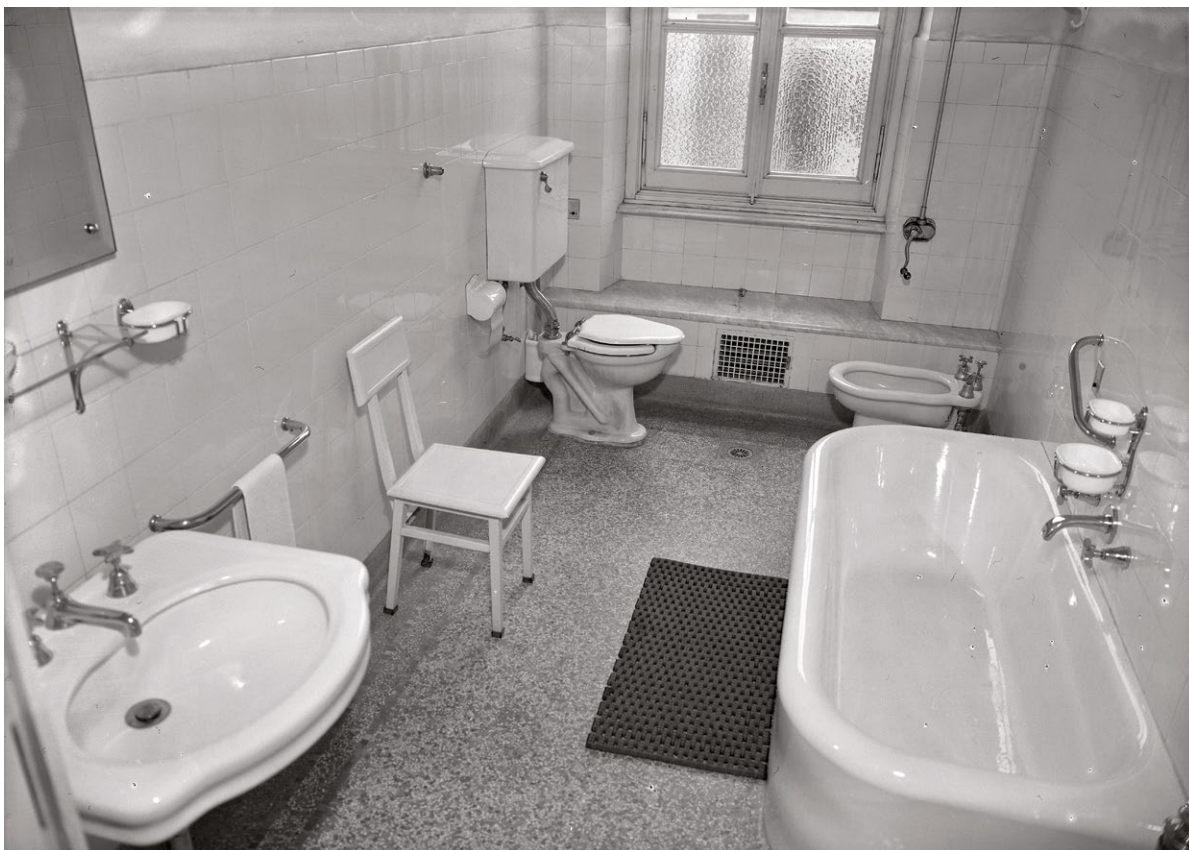
fig. 13 – AUGUSTO PEDRINI, Sala da bagno del nuovo reparto «ammalati a pagamento», [1931] (AOM, Fondo fotografico , busta 47). Stampa su carta alla gelatina a sviluppo. La fornitura sanitaria è della ditta Pozzi & Ginori; gli impianti idraulici della ditta Penoni.
