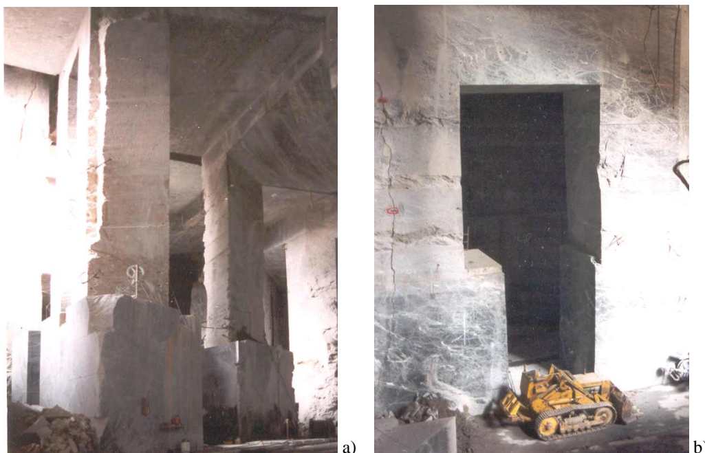
Fig.2. Esempio di vecchie coltivazioni in oficalciti di grande pregio commerciale (Verde Patrizia, valle di Gressoney –AO): nella foto a) si osserva l'irregolare distribuzione dei pilastri, talora anche molto snelli; nella foto b) è visibile una importante discontinuità subverticale che interessa completamente il pilastro posto a sinistra. La copertura è variabile da 40 a 90 m, e la cava ha disposizione parietale.
