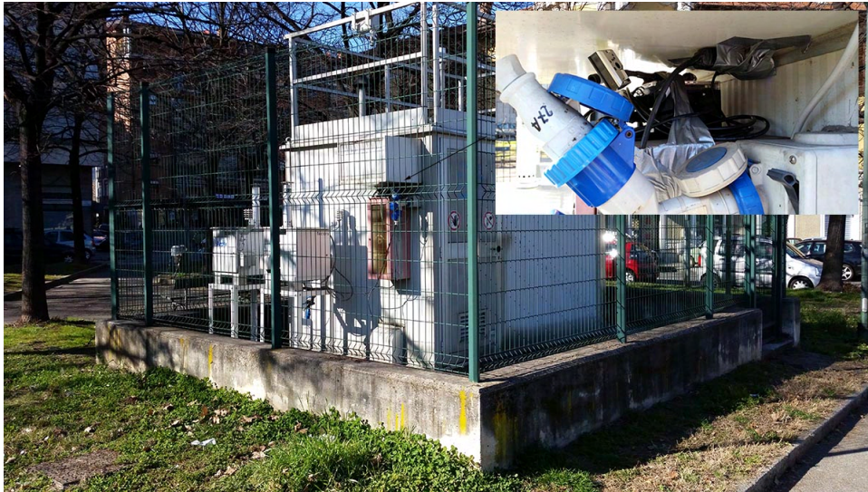
Figure 5. Test site at Rebaudengo Square in Torino. ARPA, Agenzia Regionale per la Protezione dell’Ambiente del Piemonte.
