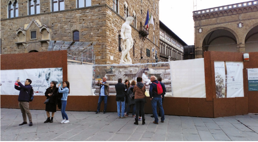
Fig.01 Restauri alla Fontana del Nettuno, Firenze (febbraio 2019). Il cantiere, circondato da pannelli riguardanti l'opera e gli interventi di conservazione, lasciava la possibilità di poter visionare direttamente questi ultimi, facendoli diventare un'occasione "social" di condivisione della cultura.
