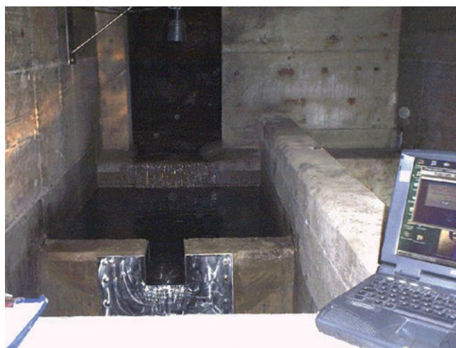
Fig. 12 - Monitoraggio in continuo della portata di una sorgente tramite stramazzo tarato e sensore di livello a ultrasuoni.
