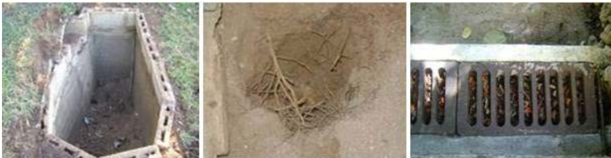
Figura 5. Evidencias de deficiencias técnicas y de mantenimiento de las obras de infiltración (Fuente: elaboración propia)
