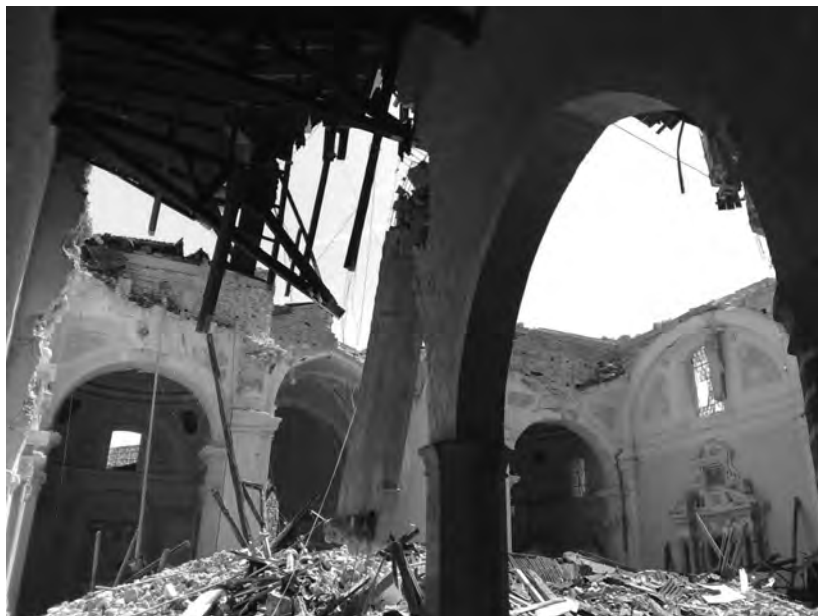
Basilica di Collemaggio a L'Aquila dopo il terremoto
