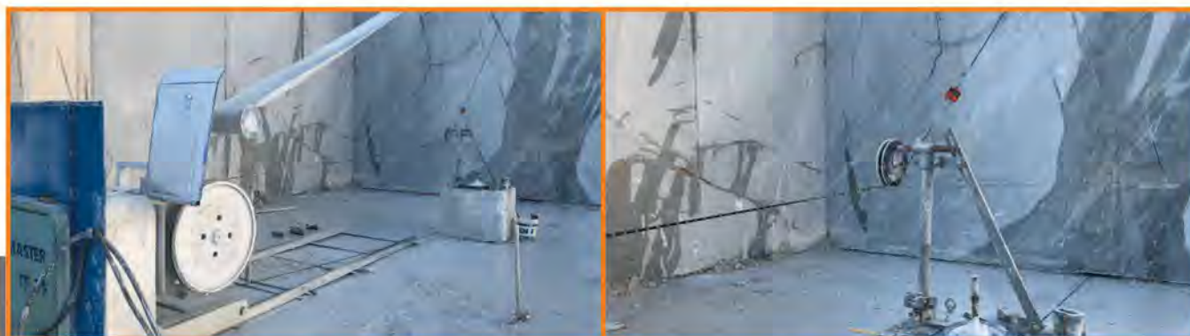
Fig.25 Taratura del taglio al monte in configurazione 2, dinamometro su lato superiore del filo / Upstream cut calibration according to layout 2, dynamometer on the upper side of the wire
