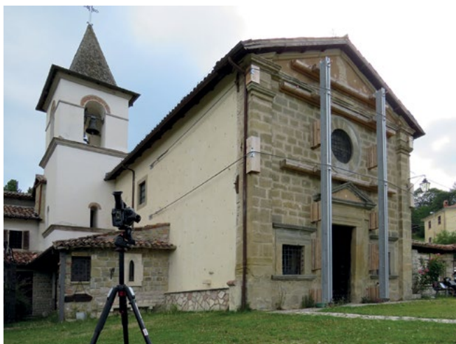
Figura 1. Puntellamento della facciata del Santuario di Santa Maria delle Grazie a Varoni.
