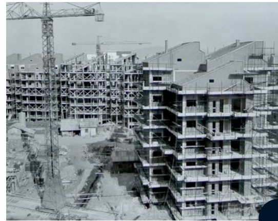
4.16 C.E.P. Le Vallette, Gruppo F per INA Casa: immagine delle torri durante il cantiere. (Archivio ATC Torino, Faldone n. 1 Busta 1)
