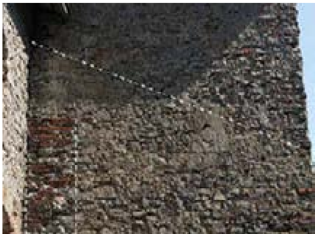
fig. 14 – Parete sud della cappella. I tratteggi indicano la traccia diagonale che separa due fasi costruttive diverse e un'apertura originaria poi tamponata con laterizi misti a pietra.
