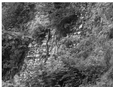
Fig. 17. Fortezza di Verrua, condizioni attuali della cortina muraria (particolare).
