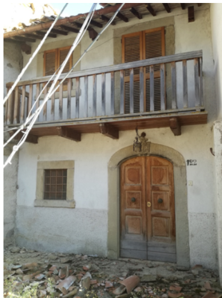
Figura 6 - Località Retrosi (Amatrice), tipici stipiti e architravi in pietra locale intatti - Retrosi (Amatrice), typical undamaged window jambs and lintels made with local stone.
