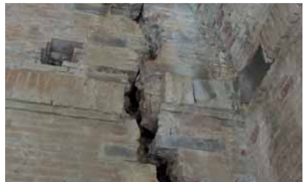
Fig. 10- I presidi in materiale lapideo utilizzati per ammorzare due paramenti interessati da una lesione, successivamente sollecitati e rotti da un nuovo movimento sismico
