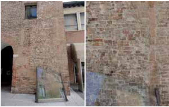
Figg. 12a-b- Interfaccia di demolizione della cortina muraria in altinelle sul lato ovest. La differenza dimensionale e il nesso stratigrafico di appoggio della cortina alla torre rafforzano l'ipotesi storiografica che la cinta muraria sia frutto di un'aggiunta, forse avvenuta dopo la conquista veneziana del 1337.
