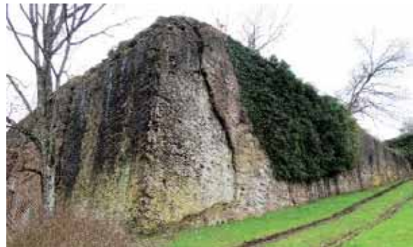
Fig. 7- Un esempio di foderatura esterna in laterizio di un paramento della Fortezza dove risulta ben visibile la scarsa ammorsatura con la muratura interna
