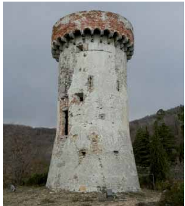
Fig. 3- Resti di intonaco sui paramenti esterni della torre di Vegliasco (Mattone, 2018)
