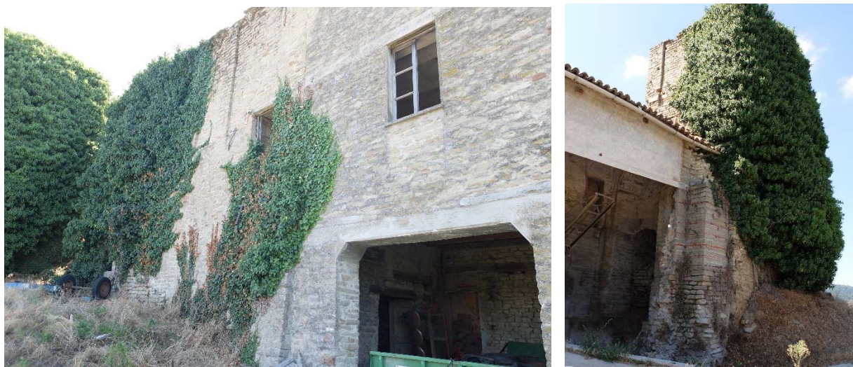
Il lato nord dell'edificio a Castino. Nella parte più alta si individuano gli archetti. La vegetazione infestante ne rende comunque difficile la lettura.
