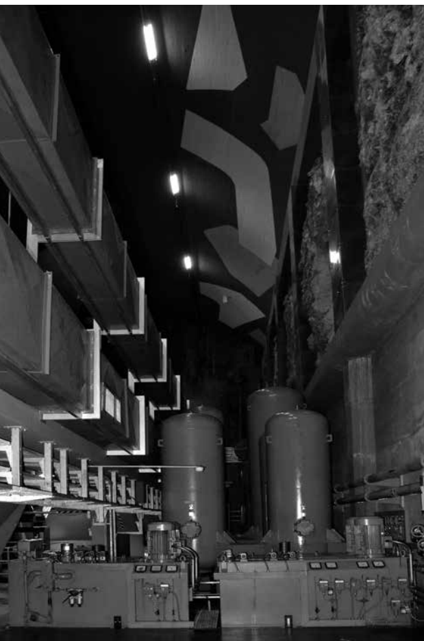
Fig. 5. - Tanes central Hidroeléctrica. Fotografía de Miguel Ángel Álvarez Areces, 2016.
