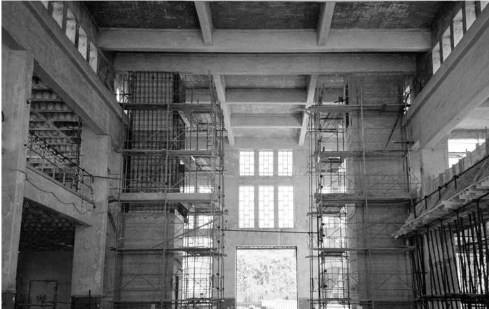
Fig. 5. - Teatro ragazzi. Si costruiscono le strutture di separazione tra sala teatrale e atrio. Fonte: Cristina Banfo, archivio servizio edifici municipali Torino.
