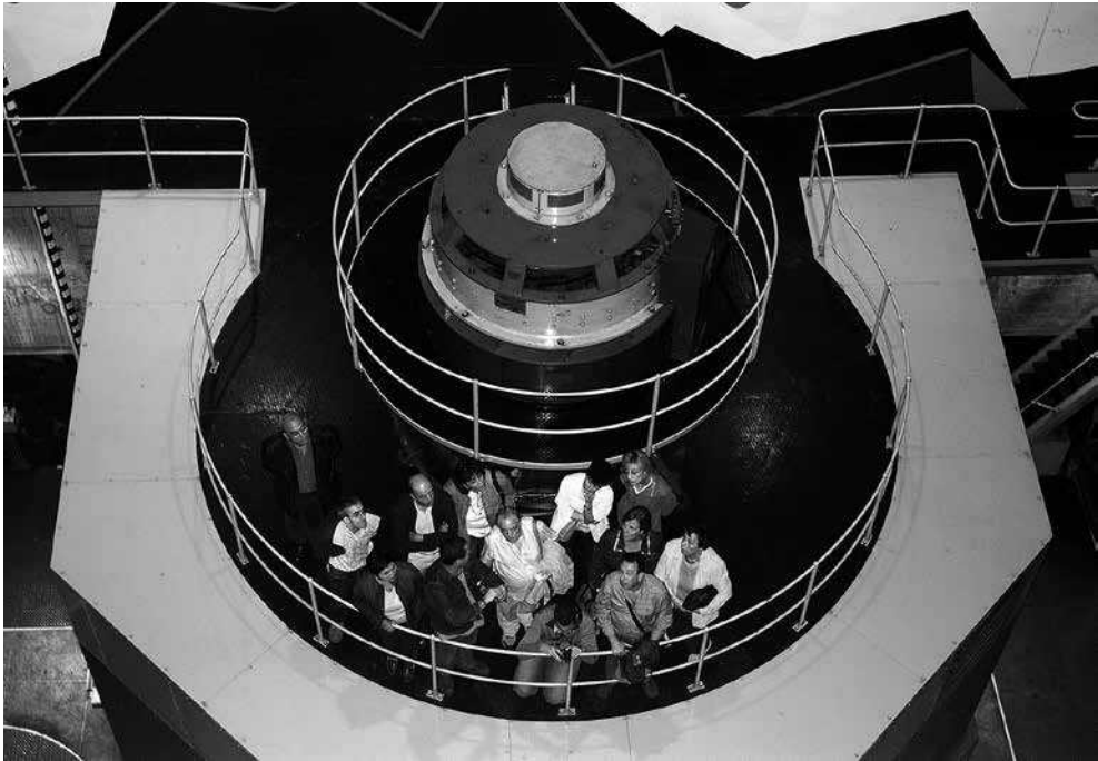
Fig. 11. - Interior de la central de Salime en visita organizada por INCUNA. Fotografía Miguel Ángel Álvarez Areces, 2011.
