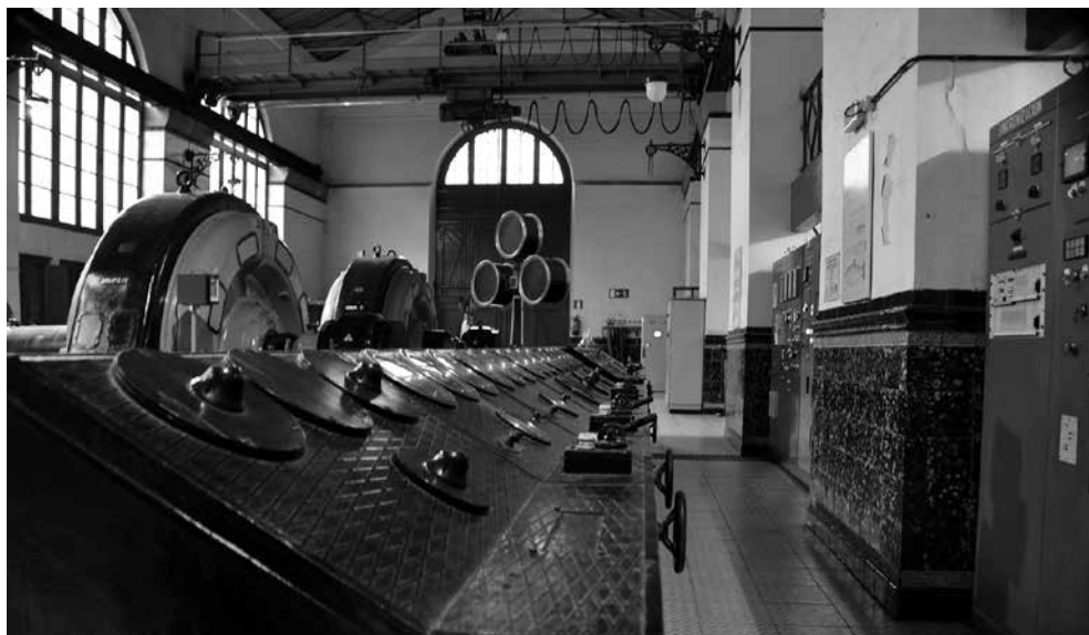
Fig. 8. - En primer plano el panel de control original, de 1917 y actualmente abandonado, de la central hidroeléctrica de La Malva en Somiedo; detrás el panel de control actualmente en funcionamiento. Fotografía de Giorgia Palma, 2016.
