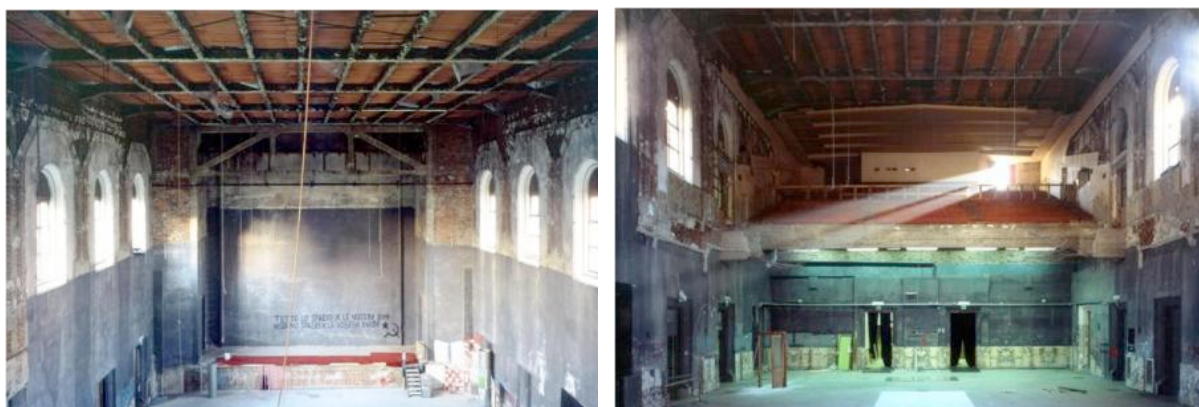
Figura 4. Alcune immagini degli interni dopo il lungo periodo di abbandono: lo spazio della sala è stato profondamente compromesso con la demolizione della galleria. Foto: Biamino, 2004.
