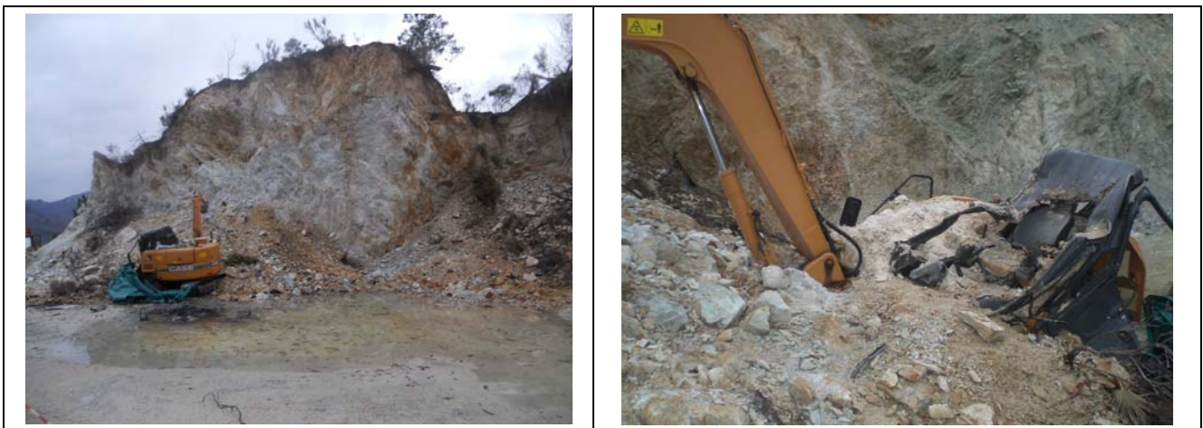
Figura 1: durante un'operazione di sbancamento si è verificato un distacco di blocchi che hanno provocato lo schiacciamento della cabina di un escavatore idraulico con martello demolitore: ripresa del luogo (a sx) e particolare della cabina (a dx)
