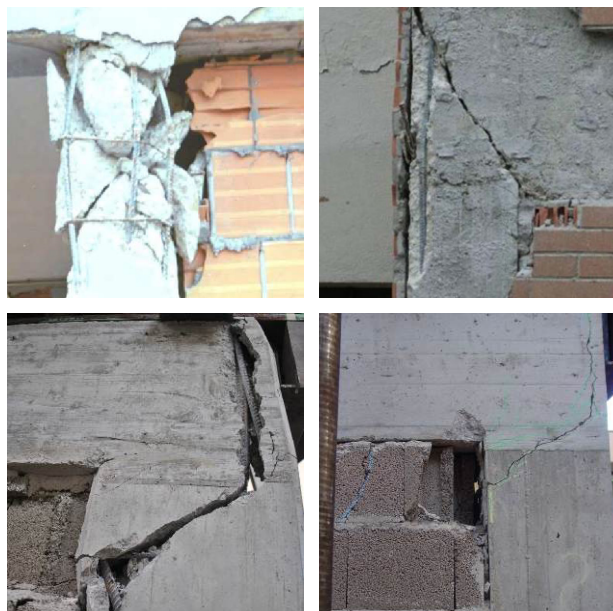
Figura 2. Rotture locali per taglio causate dall'interazione con pannelli di tamponamento.
