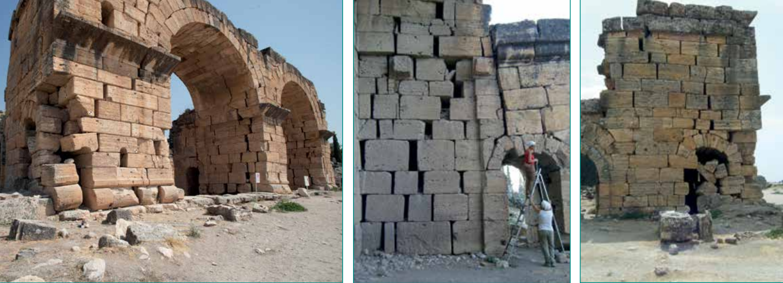
Fig. 1 - Alcuni esempi degli imponenti disesti delle murature e delle volte delle Terme-chiesa.
