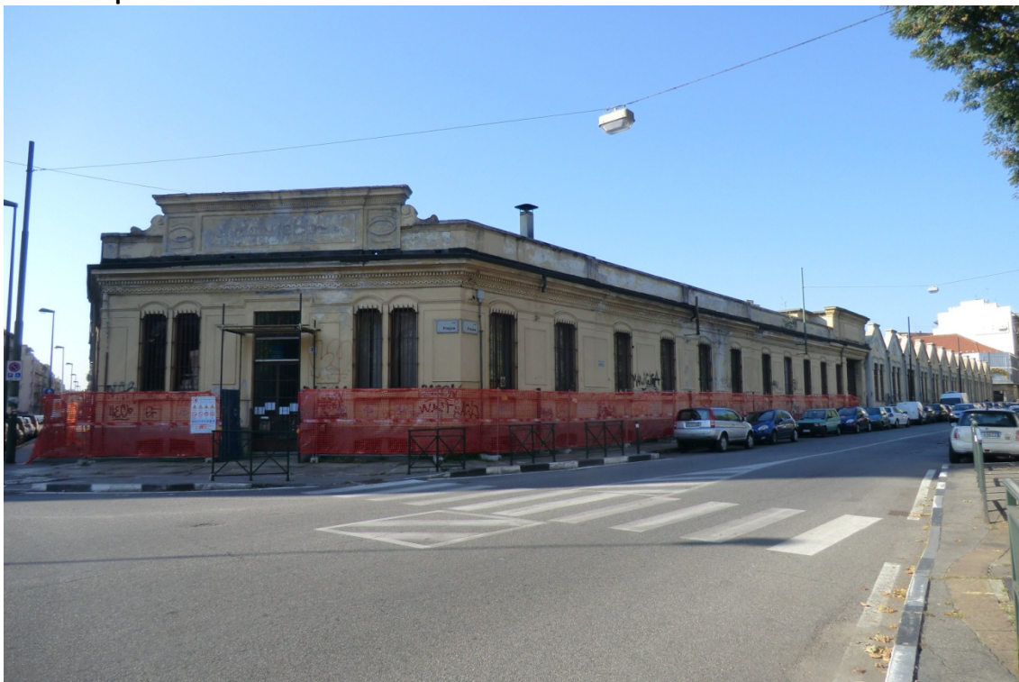
Figura 3. Vista dell'area Diatto – Snia Viscosa al termine delle demolizioni dall'angolo tra via Cesana e via Moretta. Si può osservare il mantenimento del muro perimetrale e della relativa copertura.
