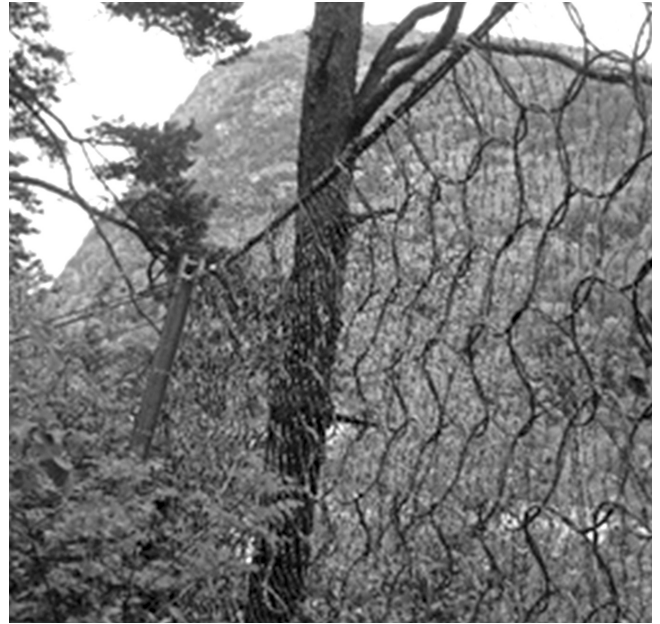
Fig. 12. Particolare di un tronco a ridosso della rete di una barriera paramassi a rete. Detail of a tree close to the rockfall protection net fences.
