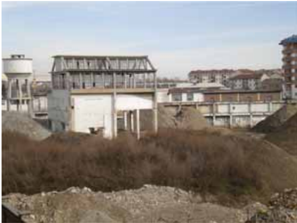
Fig. 1. Area del Parco di Spina 4, Torino, all'inizio della fase di bonifica, febbraio 2010.
