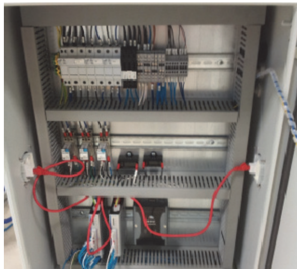
Fig. 2. Control module cabinet.
