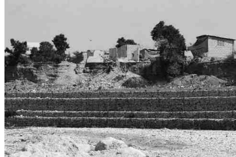
Figura 1.6: Gabbionatura degli argini del fiume Tabarre Haiti, 2012 (Fonte: E. Ponte)
