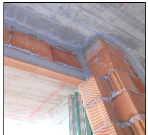
Figura 5.12. Architrave non isolata con possibile ponte termico
