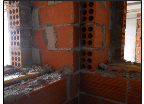
Figura 5.11. Interruzione dell'isolamento di intercapedine con ponte termico del pilastro
